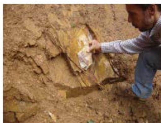
Figura 1. Taludes sacosos de 1-1,5m, em quartzito muito fraturado, com deslizamentos de pequeno volume.
