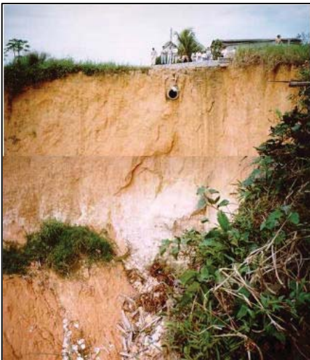
Figura 3 - Neste ponto observa-se a ocorrência de uma voçoroca originada a partir do desvio do tubo de escoamento para uma área imprópria, atualmente o muro observado na foto, já foi destruído pela erosão.
